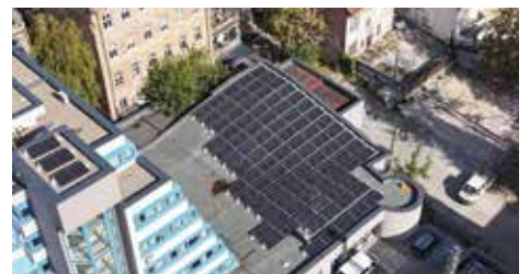
Fotonaponske elektrane na krovovima objekata A, B i C
