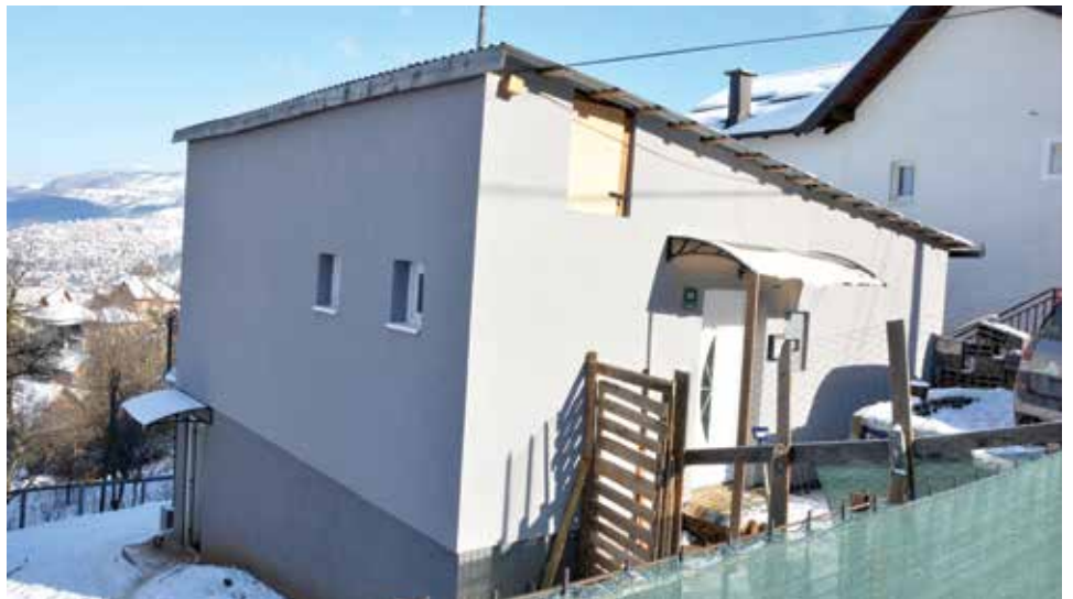
Porodici Šljokić sanirana fasada
