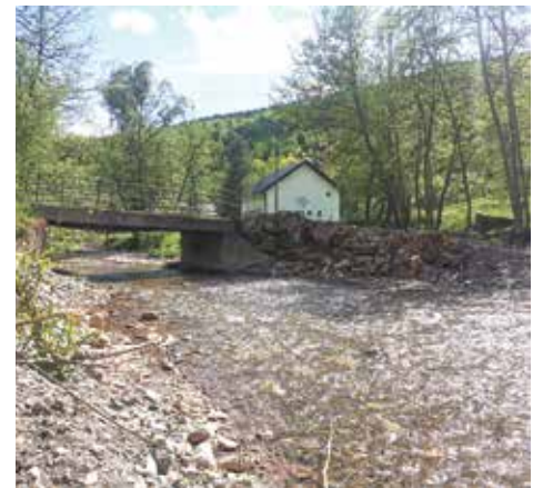
Most teško oštećen
