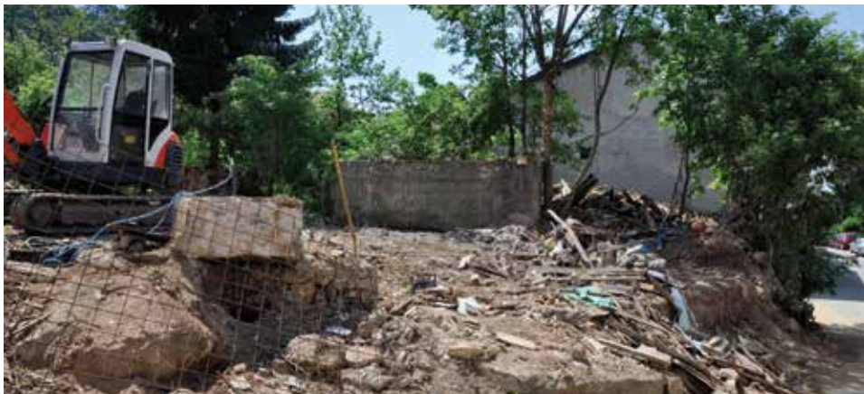
Urušeni objekti u ulici Okrugla
