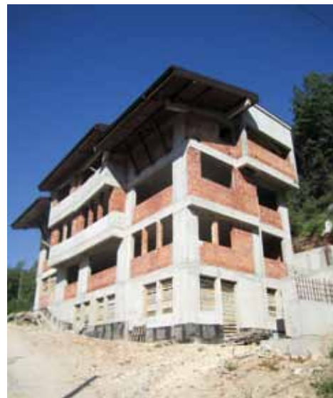
Zaustavljena gradnja zbog nedostatka novca
