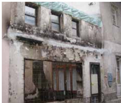
Ruševni objekat u Malom Ćurčiluku
